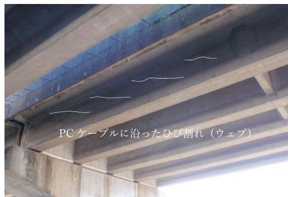
図 2-1 主桁ウェブに発生した PC ケーブルに沿ったひび割れ (白線は加筆)
