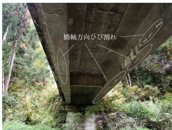
(a) 主桁下面の橋軸方向ひび割れ
