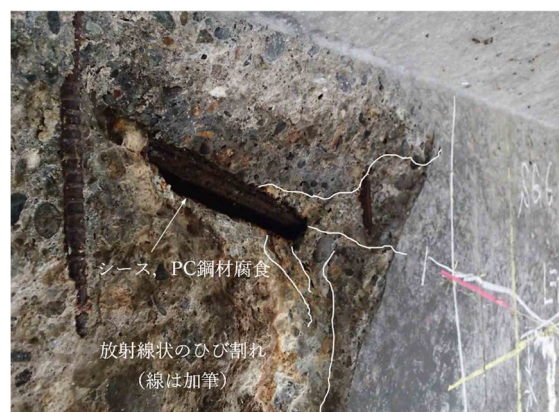
図 3-3 図 3-2 の剥離部の近景
