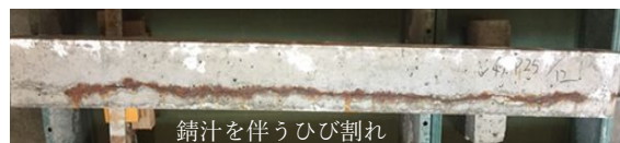
図 6-4 腐食ひび割れ状況 (SP-2)
