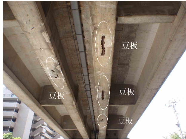
図 7-20 主桁の断面欠損（豆板）状況
