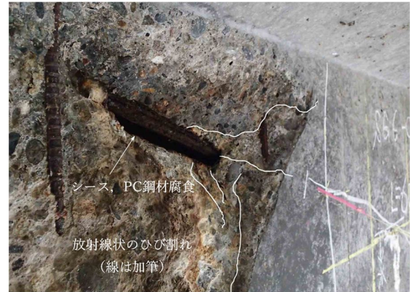
図 5-8 A 橋のひび割れ状況 (図 3-3 の再掲)
