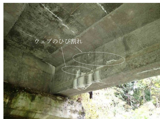
(b) ウェブの主ケーブルに沿ったひび割れ
