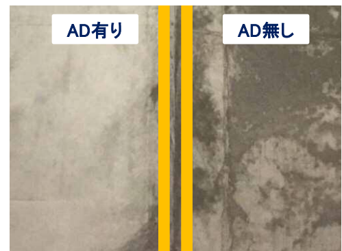
経年後のコンクリートの表面状況
