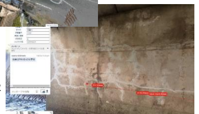
オルソ画像上に 損傷箇所を記録
