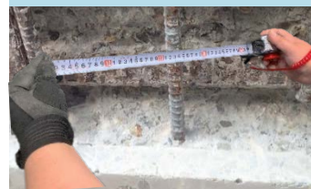
ひびわれ発生状況
